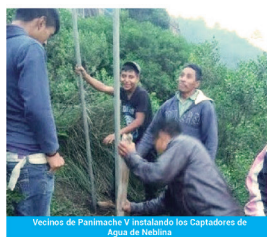
Vecinos de Panimache V instalando los Captadores de Agua de Nebina
