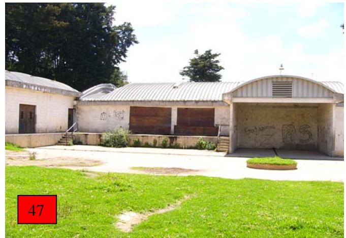
Figuras 46 y 47. Planta de tratamiento sin uso: imágenes de la planta de tratamiento que funcionó durante el período 2002- 2006 que hoy se encuentra abandonada por las autoridades municipales. Fuente: Investigación de campo, 2016.
