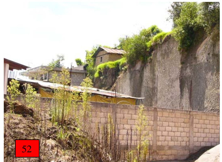
Figura 52. Viviendas construidas en áreas de riesgo: vista del límite de zona 1 (área propensa a derrumbes) Fuente: Investigación de campo, 2016.
