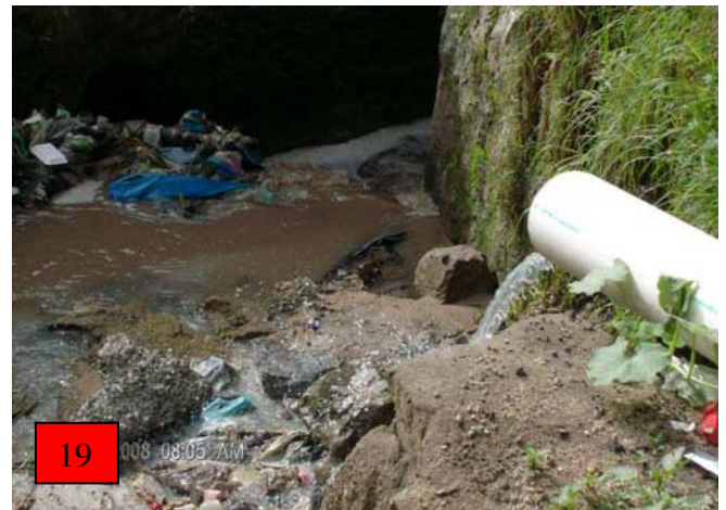
Figura No. 19 Contaminación de ríos: las aguas servidas del área urbana no tienen ningún tratamiento y, por lo tanto, son un riesgo para la salud de los habitantes y el medio ambiente. En la fotografía tomada a orillas del río “Las Palomas” se observa el desfogue de drenajes. Fuente: Investigación de campo, 2016.
