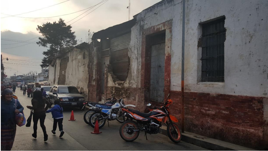
Imagen No 47 , Estado Actual de Infraestructura, sobre la 5ª. Calle. Fuente: Gramajo, José. Año: Marzo, 2016
