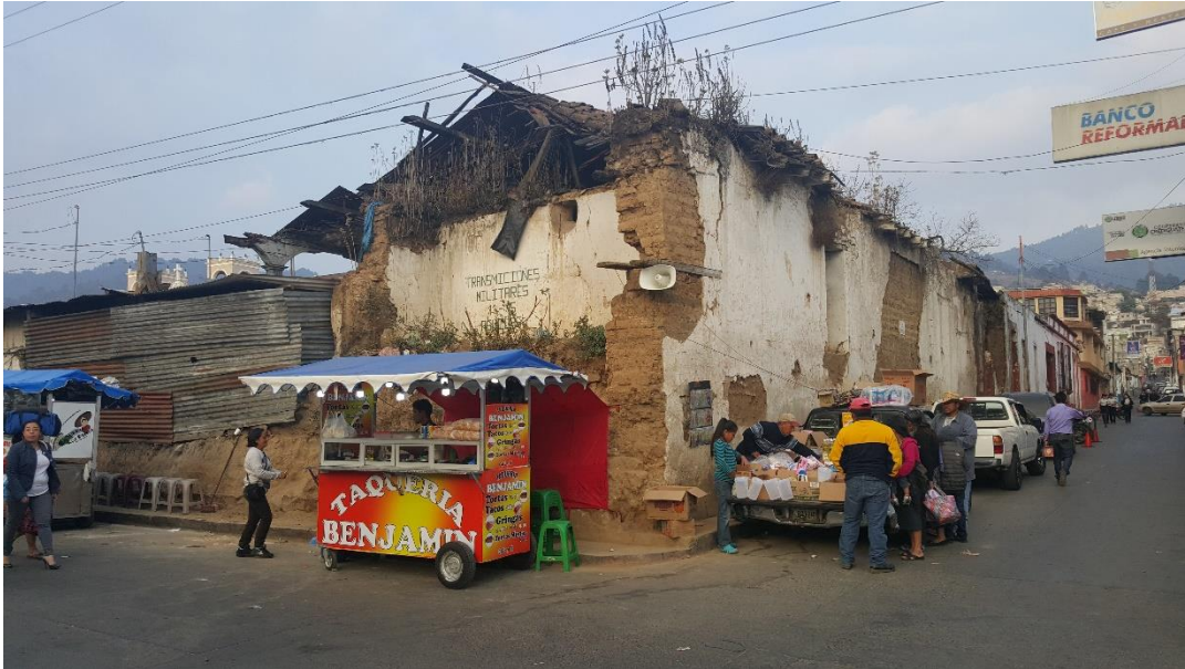
Imagen No 45, Estado Actual de Infraestructura, Esquina entre 5 Calle y 7ª. Avenida.
