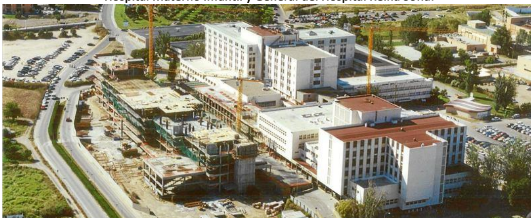
Vista Construcción del área de consulta externa frente al Hospital Materno Infantil y General del Hospital Reina Sofía.
