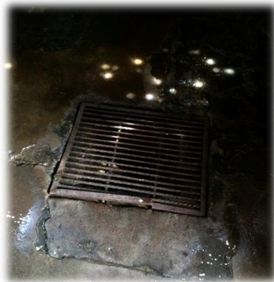
FIGURA 27 DRENAJE DEL RASTRO MUNICIPAL DE SAN ANDRÉS ITZAPA, CHIMALTENANGO
