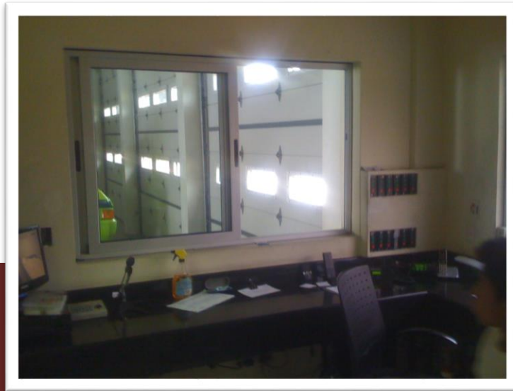
Elaboración/captura propia: 2da Estación de Bomberos Municipales, 10-40 Boulevard Liberación Cabina en el cual se controla las alarmas.
