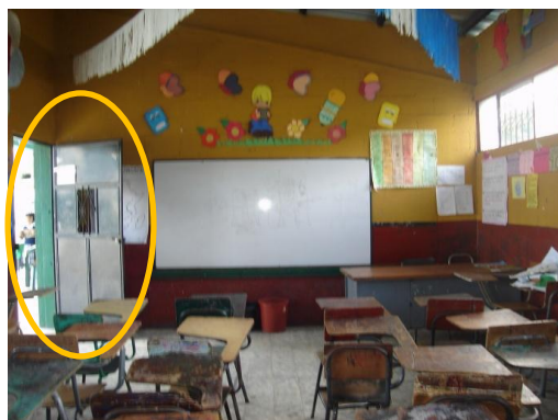
Fotografía No.13: Abatimiento de Puerta
