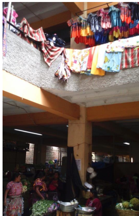
Manejo de pozos de ventilación que también crean una doble altura en el edificio.
