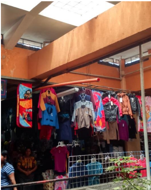
Se colocaron sifones en la parte superior del edificio para evitar calentamiento de los locales.
