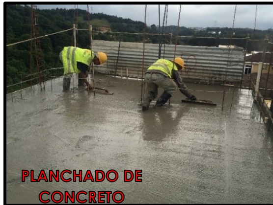
PLANCHADO DE CONCRETO Imagen No. 118 Autor: Cristian Juárez Proyecto: Bosques de Arrazola, 2016
