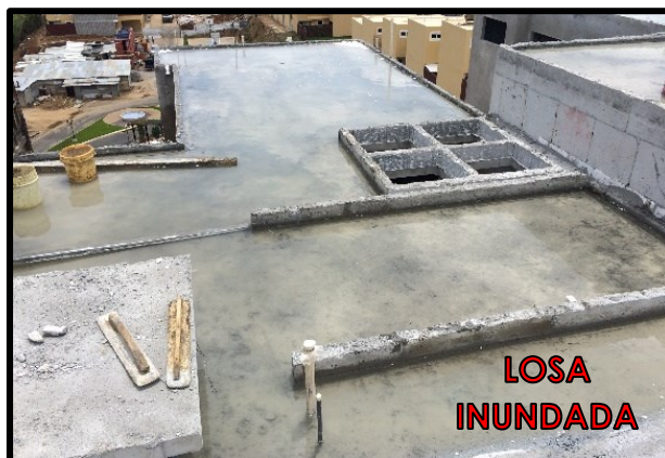
LOSA INUNDADA Imagen No. 120 Autor: Cristian Juárez Proyecto: Bosques de Arrazola, 2016
