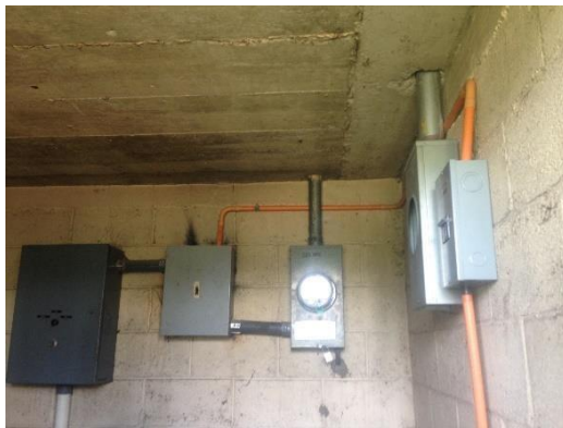
Imagen 18 Interior de Cuarto de Maquinas Elaboración Propia Año 2015
