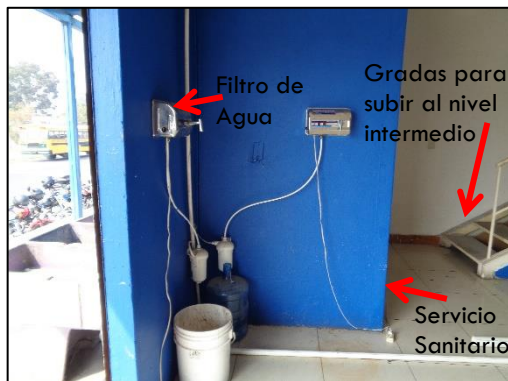
Fotografía No. 59: Abastecimiento de agua purificada. Fuente: Elaboración Propia, 2016.
