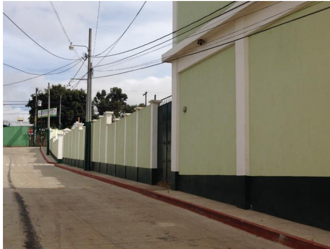
Ilustración 54 Cableado desordenado, Fuente: 7 de noviembre 2015, Elaboración propia.
