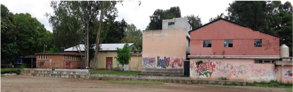
Contaminación visual en paredes, paredes manchadas con grafitis
