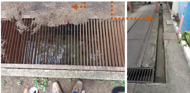
El terreno cuenta con tragantes que se conectan a través de una red local para drenar el agua lejos de los módulos construidos.
