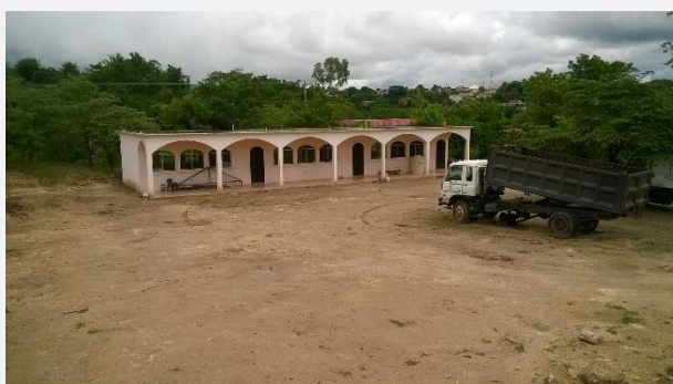
Imagen 39. Primeras aulas del Instituto Diversificado Municipal, en proceso de construcción. Fuente: Propia.
