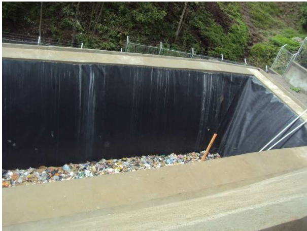
Foto 5. Relleno sanitario en funcionamiento con la protección en los taludes mediante geo-membrana para evitar la contaminación del suelo y la filtración hacia el manto freático. Foto propia tomada en junio de 2015.
