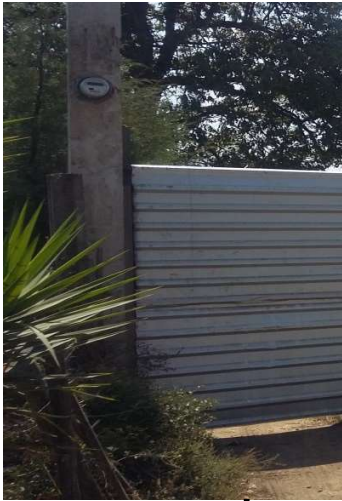
CONTADOR DE LUZ UBICADO EN EL INGRESO AL TERRENO, CONTADOR DEL TERRENO. EXISTE ALUMBRADO ELECTRICO EN LA PARTE DE LA CALLE PRINCIPAL
