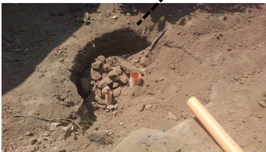
POZO DE ABSORCIÓN. UBICADO EN LA PARTE MÁS BAJA DEL TERRENO
