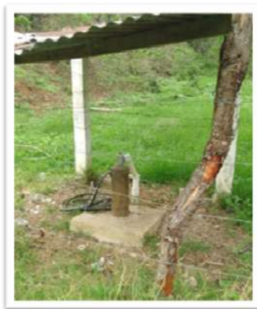
Figura 30 POZO MECÁNICO CENTRO UNIVERSITARIO.
