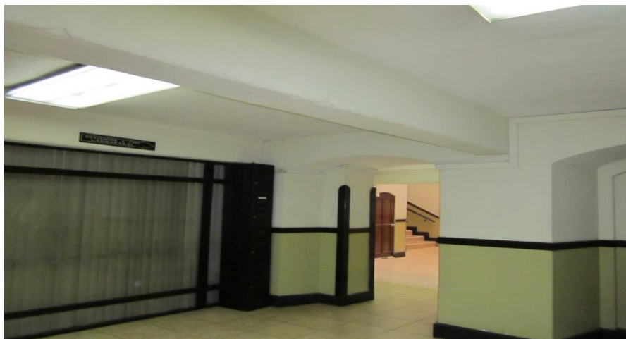
Vista general de la sección con el numeral del sótano, de SE a NO.
