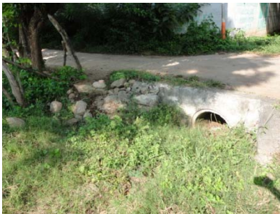
Paso de Agua Pluvial frente a terreno Foto No. 5.2.6 F2
