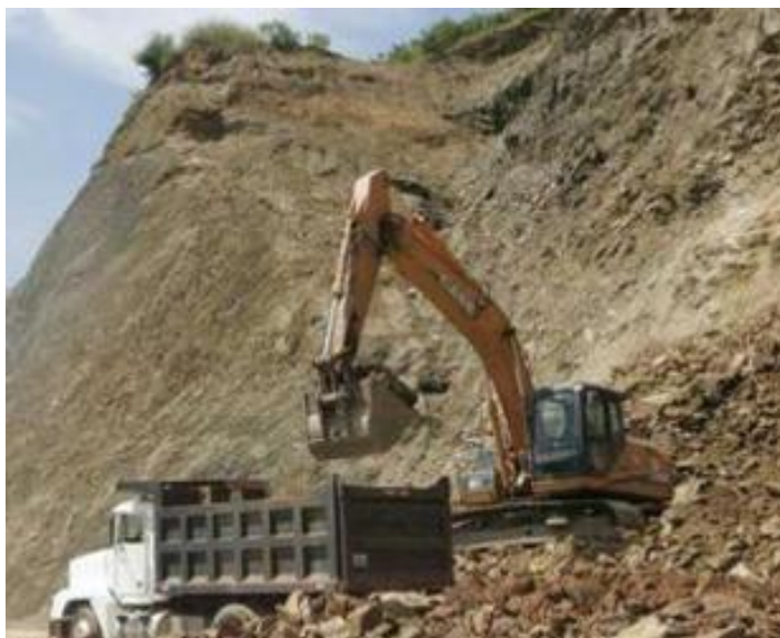
Figura 3. Deslave ocurrido entre el Casco Urbano y la Aldea Agua Zarca, Dirección Municipal de Planificación, 2,012.
