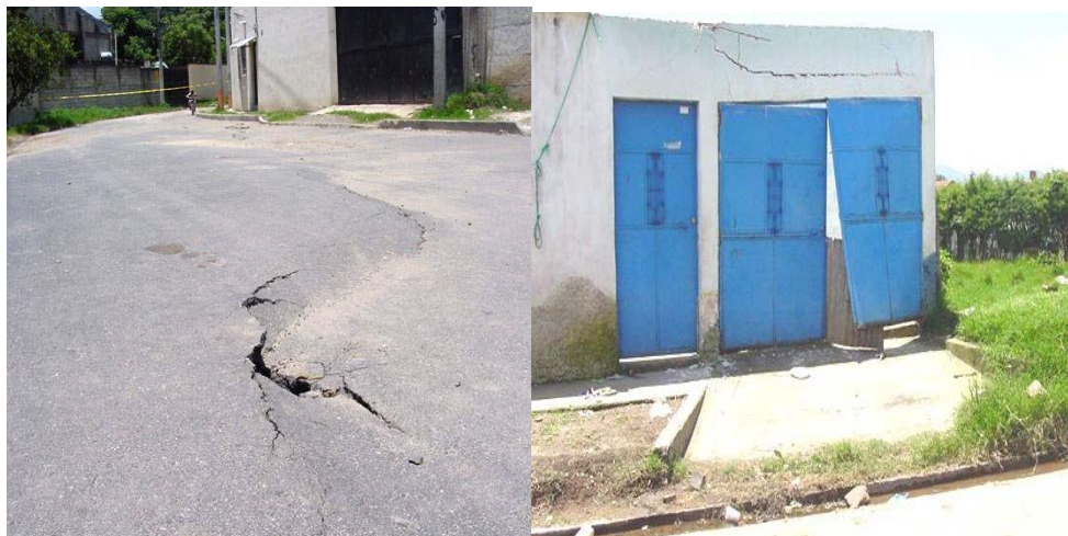
DAÑOS POR SISMO EN EL ÁREA DEL FRUTAL, EN LA PARTE NORTE DE LA CUENCA DEL LAGO (Fotos: AMSA 2010)
