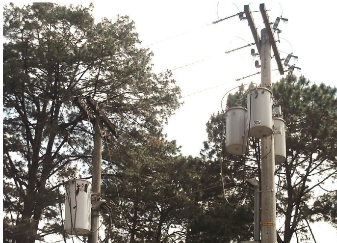
Figura 39 Acometida eléctrica que se encuentra sin ser conectada a red principal de energía eléctrica. Autoría propia.
