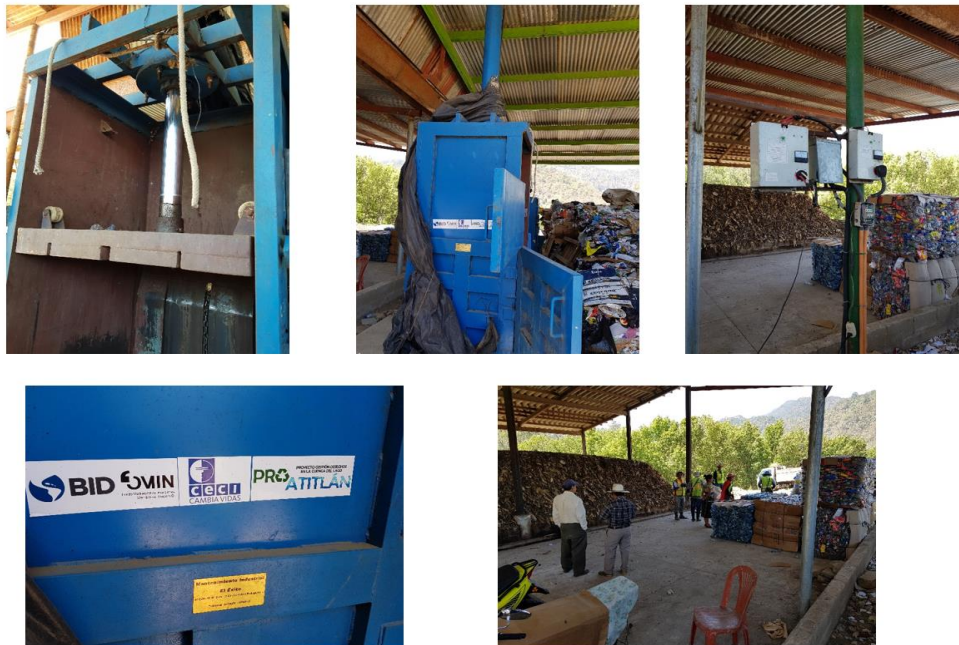
Figura 44 área interior de compactación de reciclables.
