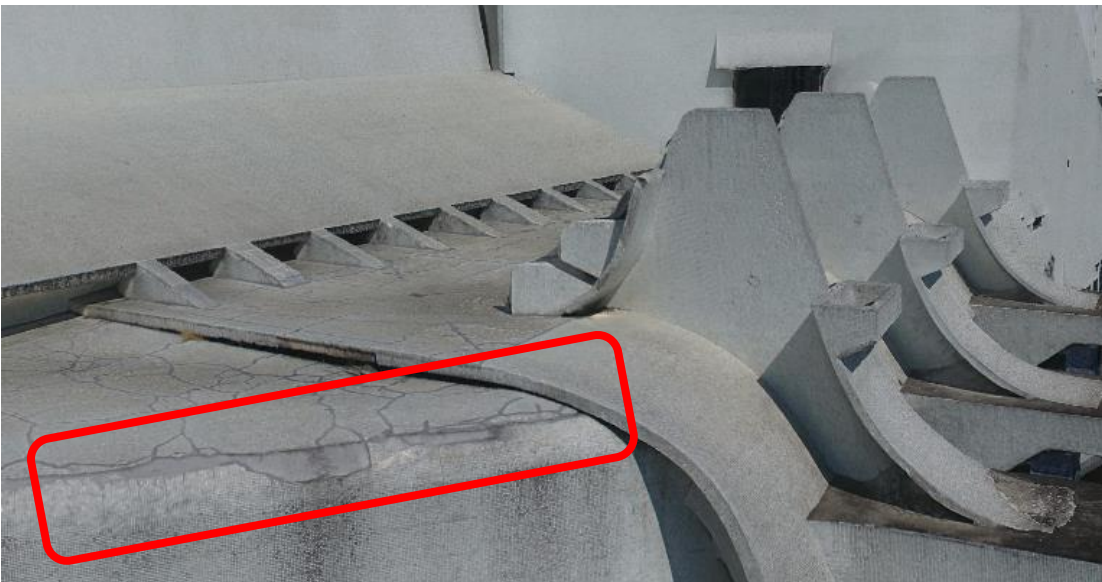
Ilustración 106 Desprendimiento de material
