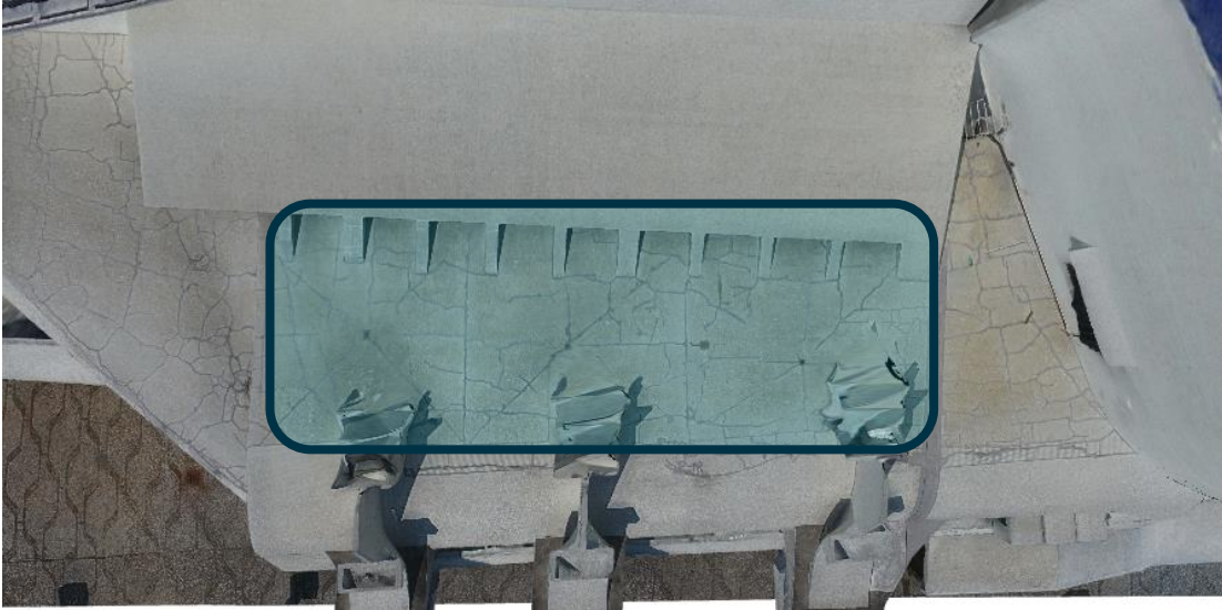
Ilustración 105 Agrietamiento por efectos del agua
