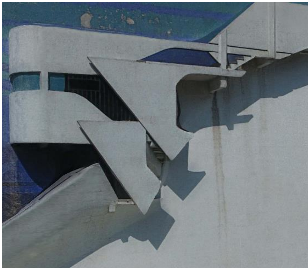
Ilustración 107 Presencia de humedad
