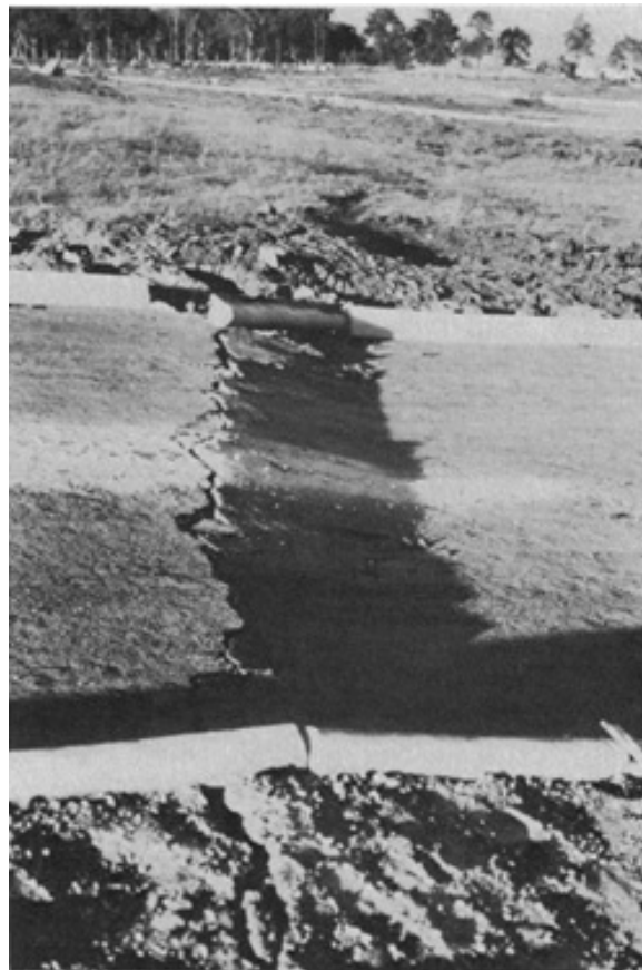
Figura 8. Ruptura cerca a la Colonia El Milagro.
