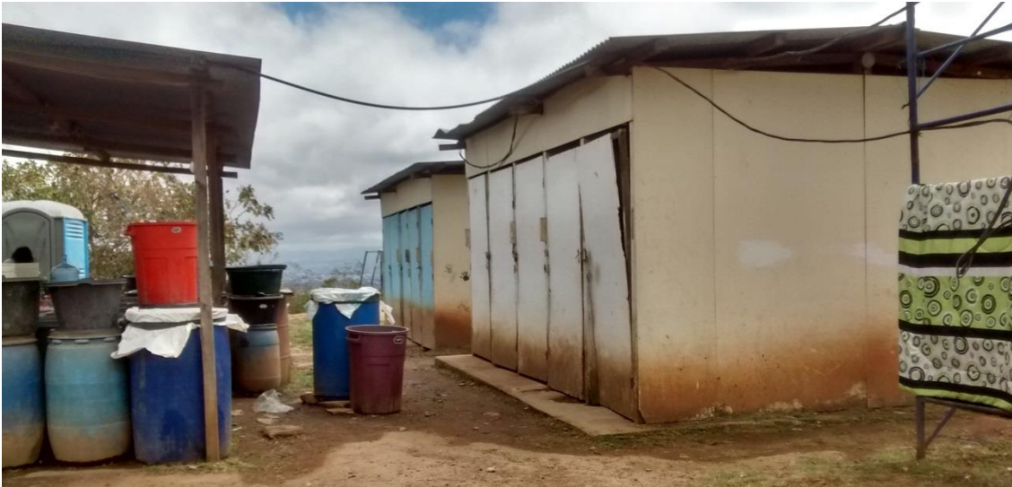
Fatiga en los materiales de cerramiento vertical (duchas comunales). Imagen 5: fuente, propia.
