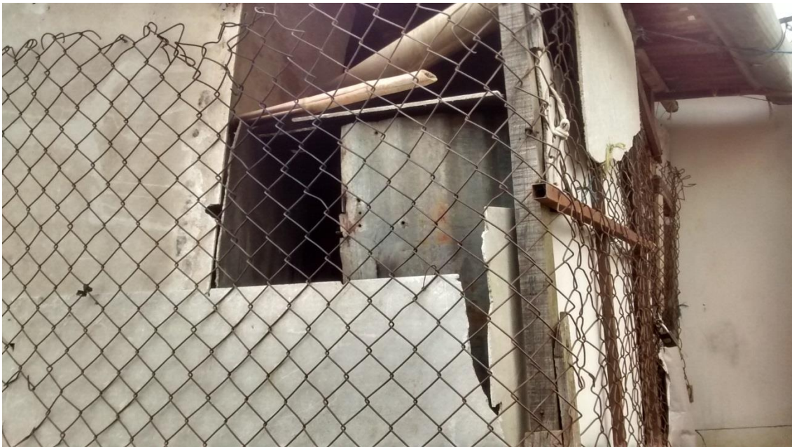
Fatiga en los materiales de cerramiento vertical (cerramiento en vivienda). Imagen 6: fuente, propia.
