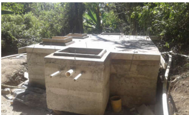
Figura 34 Tanque de Mampostería, Caserío el Mezcal, Purulhá, Fotografía Propia 2017
