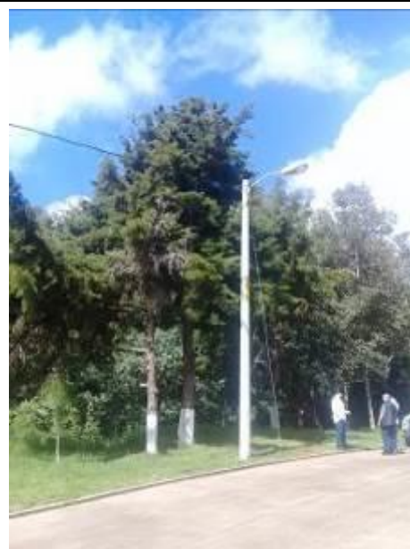
Figura 29. Poste de concreto de 6.00m de alto utilizado para el alumbrado público, sujetado con sus respectivos tensores.
