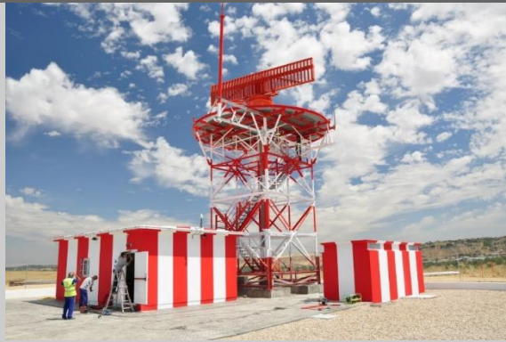
Ilustración 44: Sistema de radares de tráfico aéreo. Fuente: http://www.semi-group.com/ftp/comunicaciones/estaciones%20radar/DSC_0355.jpg
