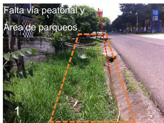
Foto No.39, Falta de acera peatonal, Fuente: Propia
