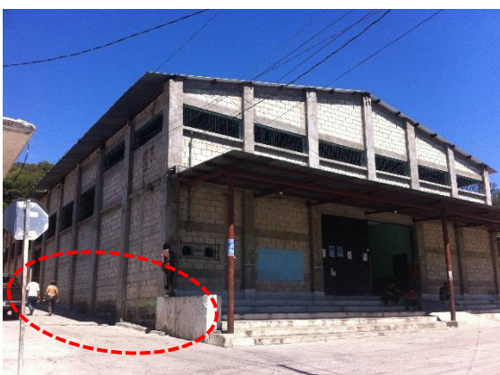
Foto No.62, Falta de banqueta, Fuente: Propia
