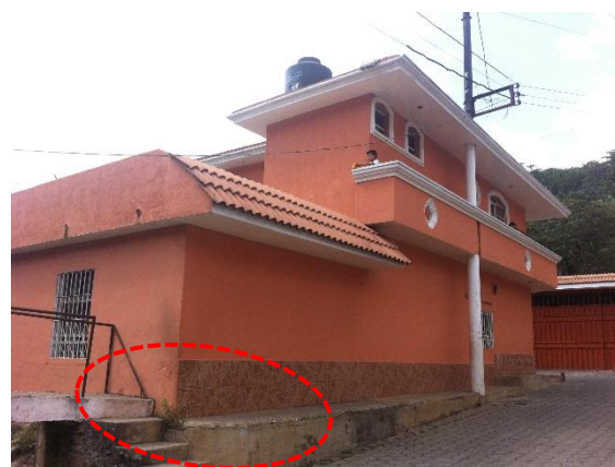
Foto No.65, Irregularidad de banquetas, Fuente: Propia
