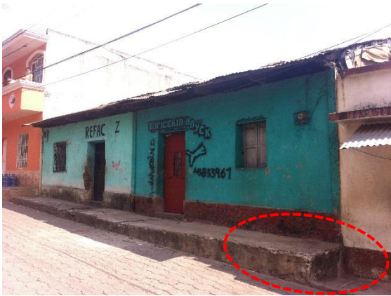
Foto No.64, Irregularidad, alturas de banquetas, Fuente: Propia
