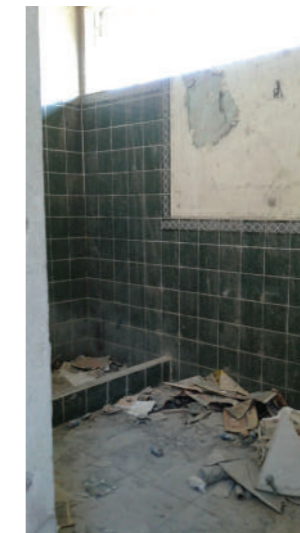
SERVICIOS SANITARIOS CON DAÑOS EN REVESTIMIENTOS DE MUROS, ARTEFACTOS SANITARIOS Y ACCESORIOS FUERON QUITADOS O SE ENCUENTRAN DAÑADOS
