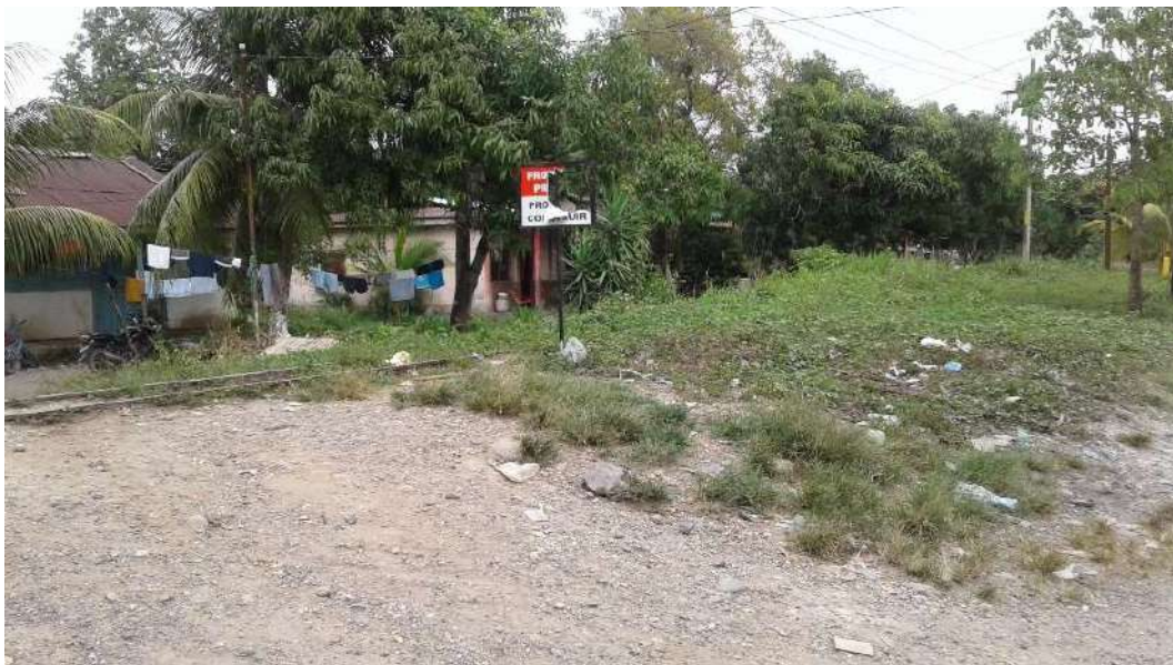
Figura 3. Señalizaciones dañadas, se encuentran colocadas en la vía férrea Puerto Barrios - Entre Ríos. FUENTE: Elaboración propia, 2017
