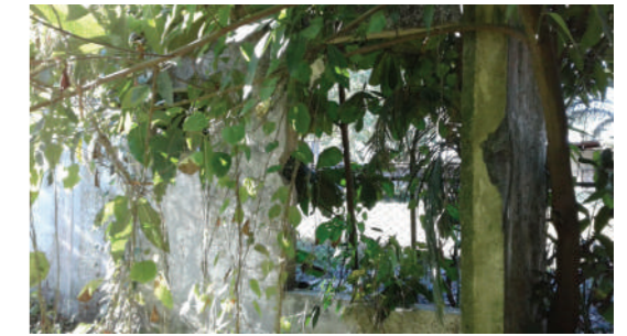
LÍMITES DE LA EDIFICACIÓN, LOS MUROS CUENTAN CON ALGUNAS GRIETAS Y FISURAS. HAN SIDO RODEADOS DE VEGETACIÓN A CAUSA DE SU CRECIMIENTO Y FALTA DE CUIDADOS ADECUADOS POR EL ABANDONO DE ESTA.
