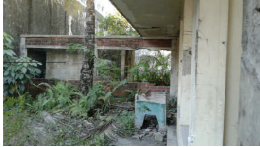
MURO DE LADRILLO CON DAÑOS EN VANOS, LOSA EN CONDICIONES ADECUADAS, ÚNICAMENTE MUESTRA DAÑOS EN REVESTIMIENTOS Y PINTURA AL IGUAL QUE LOS MUROS EXTERIORES.
