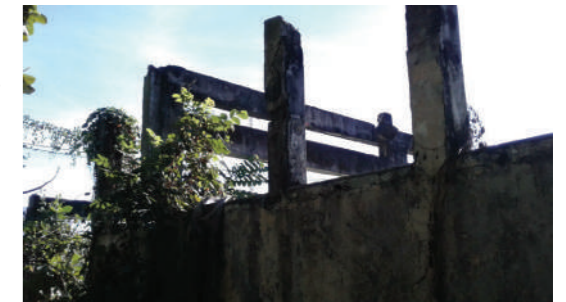
FALTA CUBIERTA, EN UN INICIO SI EXISTIÓ PERO FUE QUITADA, DEBIDO A ESTO LOS MUROS TIENEN MÁS DAÑOS EN EL REVESTIMIENTO A CAUSA DE LOS FACTORES CLIMÁTICOS. SE ENCUENTRA GRAN CANTIDAD DE CRECIMIENTO DE VEGETACIÓN.
