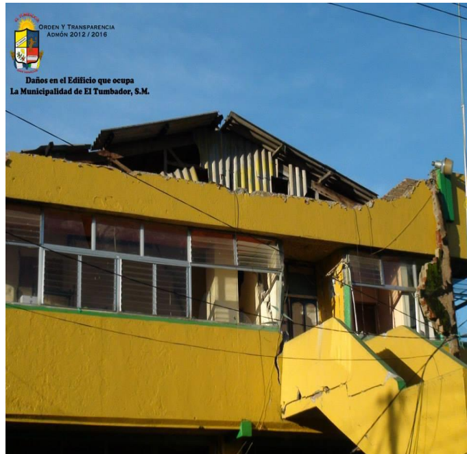
Figura No. 2 Daños de edificio Municipal Fuente: Municipalidad de El Tumbador
