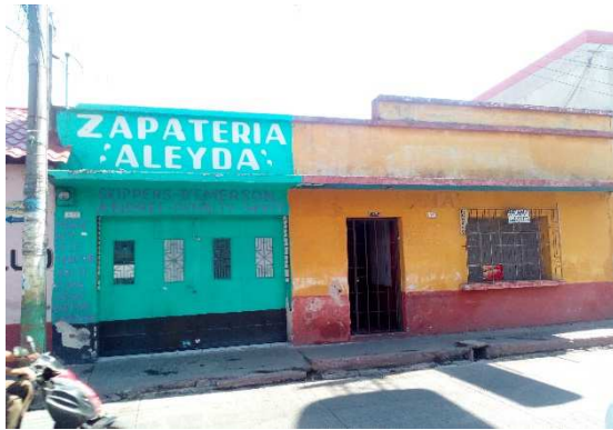
Figura 61. Viviendas post terremoto, mezcla de sistemas constructivos, restos de adobe y uso de concreto y mampostería. (Fotografía: propia).
