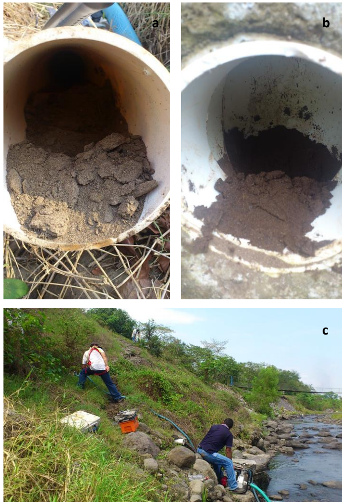
Figura 44. a y b) Problema de Azolvamiento en las tuberías, c) Equipo de mantenimiento del ICC
