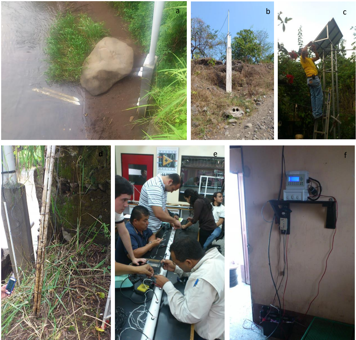
Figura 38. instrumentación SAT-GAL. a y b) base de concreto reforzado para sonda de inmersión, c) instalación de panel solar, d) sonda de inmersión, e) capacitación a personal de CONRED, ACH e ICC en construcción de sonda Galileo, f) instalación de componentes en casa del voluntario.
