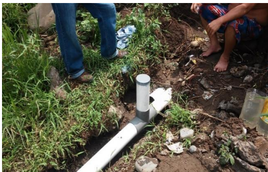
Figura 42. Entrada para limpieza de tubería
