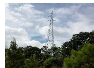
Figura 99. Vista de una de las torres para las líneas de alta tensión. Fuente: Elaboración propia.
