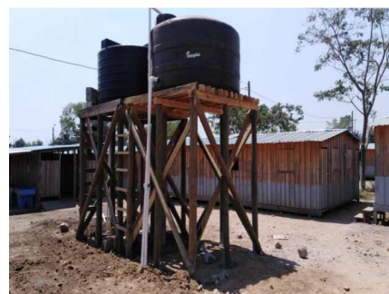
Tanques de Rotoplast sobre torres de madera para abastecer del vital líquido a los albergados en los ATU.
