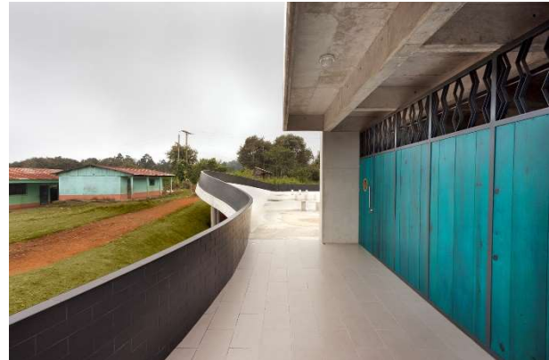
-Figura 33- Desnivel en Losa, Escuela San Felipe Chenla.
