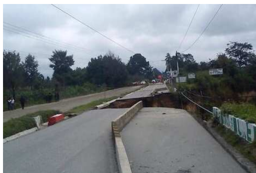
Figura No. 78. Colapso en el 148 km de la carretera que conduce de Chichicastenango a Santa Cruz del Quiché. Fuente: Prensa Libre, septiembre de 2013.
