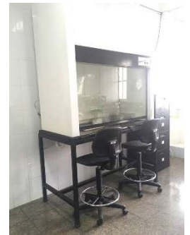
Imagen No. 39 Campana de extracción de gases laboratorio fac. Medicina Veterinaria y Zootecnia. Elaboración propia.
