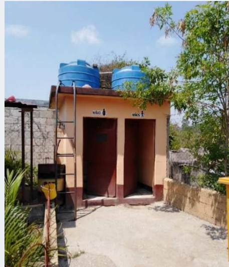
Figura 104. Tanques de almacenamiento de agua para servicios sanitarios Escuela Preprimaria Monte Grande, Sanarate, El Progreso. Fuente: propia (junio 2019).
