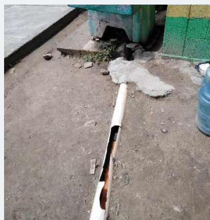
Figura 17. Tuberías expuestas y quebradas. Fuente: propia (abril 2019).
