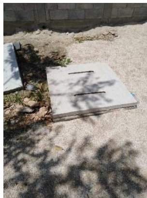
Figura 155. Cajas de registro. Fuente: propia (octubre 2019).
