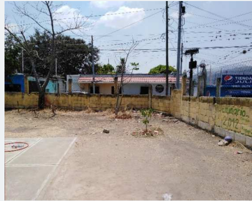
Figura 21. Muro perimetral en mal estado. Fuente: propia, (abril 2019).
