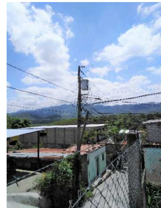
Figura 153. Poste con transformador. Fuente: propia (octubre 2019).
