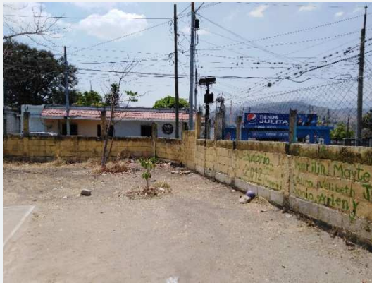
Figura 20. Muro perimetral en mal estado Fuente: propia (abril 2019).
