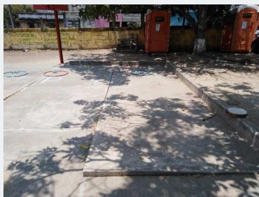
Figura 11. Pavimento de cancha levantado por raíces de los árboles. Fuente: propia (abril 2019).
