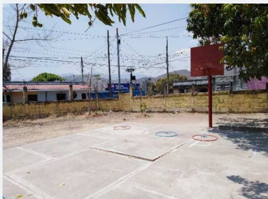
Figura 25. Espacios recreativos en mal estado Fuente: propia (abril 2019).
