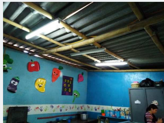
Figura 54. Iluminación dentro de cocina, Escuela R. de Haití. Fuente: propia.
