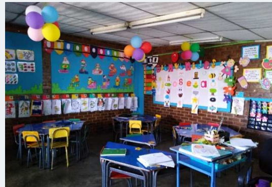
Figura 61. Uso de cielo falso en salones de clase. Fuente: propia.
