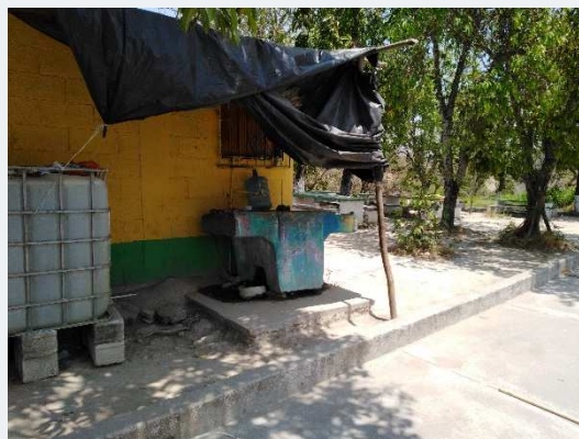
Figura 15. Área de limpieza y lavado en mal estado. Fuente: propia (abril 2019).
