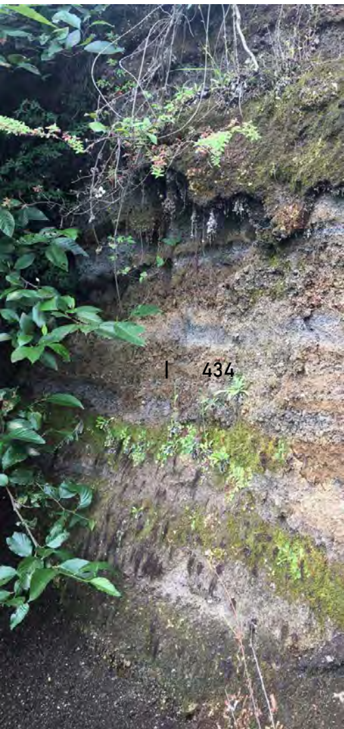
Figura 49: erosión de taludes. Fotografía propia, febrero del 2019
