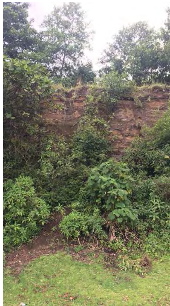
Figura 51: talud inestable dentro del terreno designado. Fotografía propia, febrero del 2019
