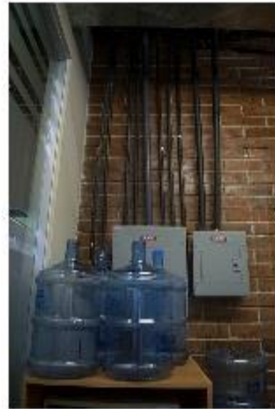
1. INSTALACIONES COLOCACIÓN INADECUADA MURO
