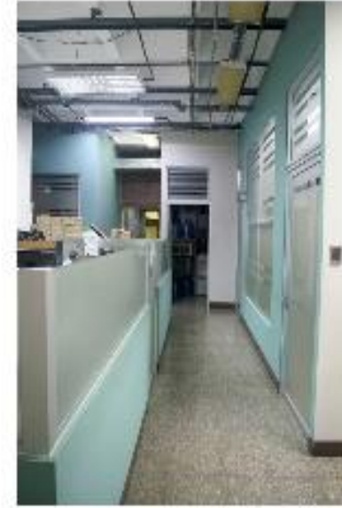
3. TABLAYESO ALTERACIÓN DEL ESPACIO MUROS
