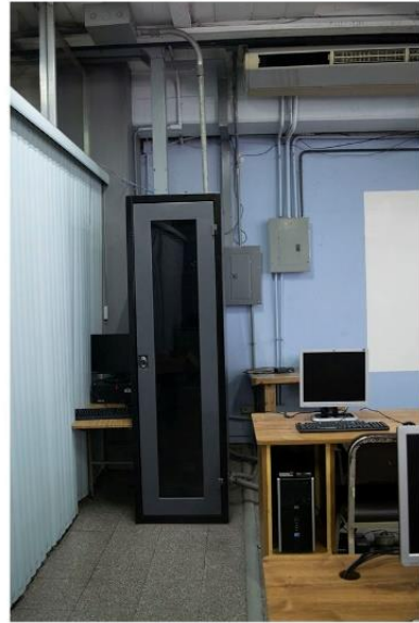
1. INSTALACIONES COLOCACIÓN INADECUADA MUROS / VIGAS / CUBIERTA
