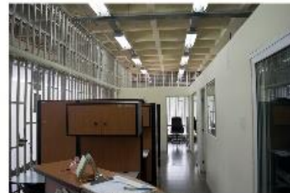
5. VIDRIO / ALUMINIO DESGASTE / OXIDO MURO
