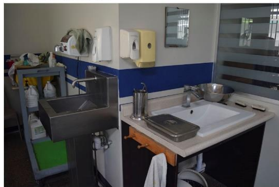
3. INSTALACIONES ALTERACIÓN DE ESPACIO INSTALACIÓN HIDROSANITARIA
