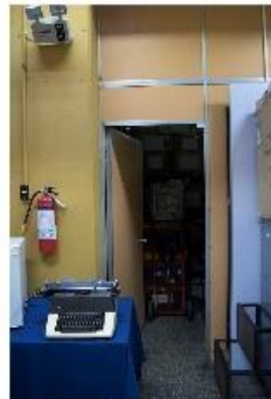
4. CONCRETO SUPERPOSICIÓN DE PINTURA COLUMNA
