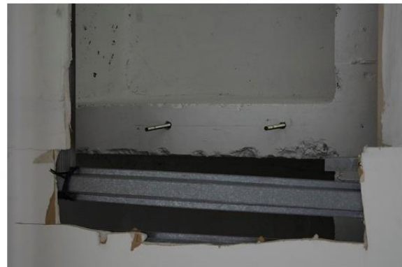
4. CONCRETO DESPRENDIMIENTO DE MATERIAL CUBIERTA
