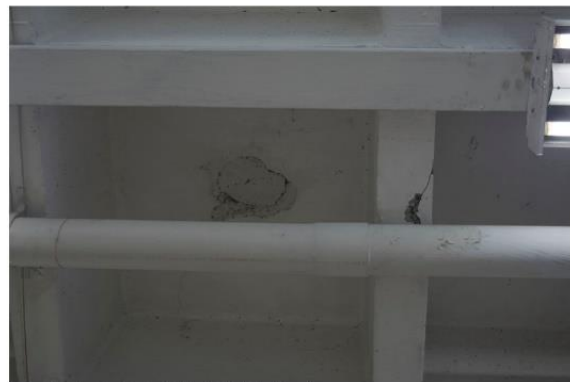
3. LOSA NERVADA DESPRENDIMIENTO DE MATERIAL CUBIERTA
