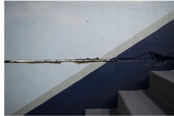
2. CONCRETO DESPRENDIMIENTO DE MATERIAL MURO
