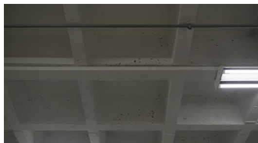
Figura 40. Vista de la losa nervada en 4to Nivel. Fotografía de Sergio Santana 2019
