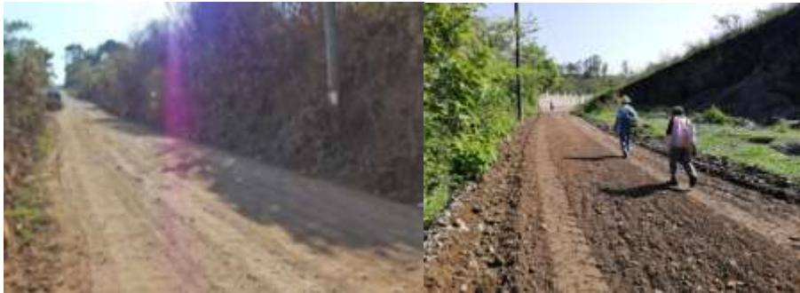
Figura 41, fotografía del estado actual de la carretera. http://www.facebook.com/MuniPalenciaGT/
