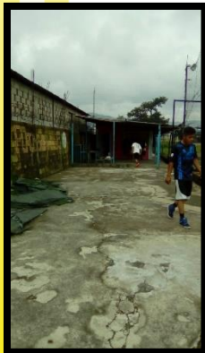
Figura 65: F-7: Se observa el área de graderío y corredor que sirve de circulación para ingresar a las canchas. El graderío está hecho con acero el cual se encuentra oxidado en su totalidad y cuenta con una cubierta de lámina. Nuevamente se puede observar el muro perimetral sucio y con humedad y los alambres caídos que servían como protección para que nadie pudiera ingresar al área.
