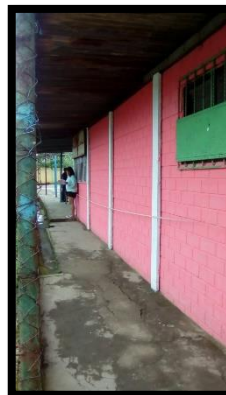
Figura 64: F-6: En la imagen se observa parte del área de cobro, el espacio de circulación es reducido ya que su función es no permitir el ingreso a quien no ha pagado. Es el único elemento arquitectónico que se encuentra en buen estado tanto por dentro como por fuera.
