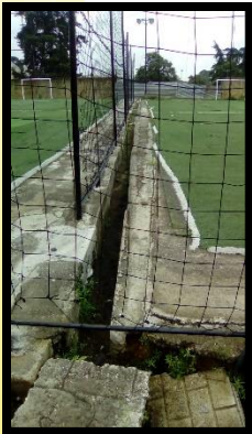
Figura 63: F-4: Se puede observar las plataformas en las que se encuentran ubicadas las canchas. Cuenta con un Drenaje para conducir el área de lluvia hacia el barranco que colinda en la parte trasera del terreno, este no se encuentra protegido con rejilla u otro elemento. En la parte de enfrente que es por donde ingresan a la cancha la acera es de concreto, el cual se encuentra rajado y quebrado en algunas áreas.
