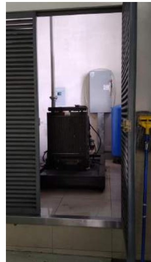
Imagen 28 Planta eléctrica. Fuente: fotografía propia, 2020.
