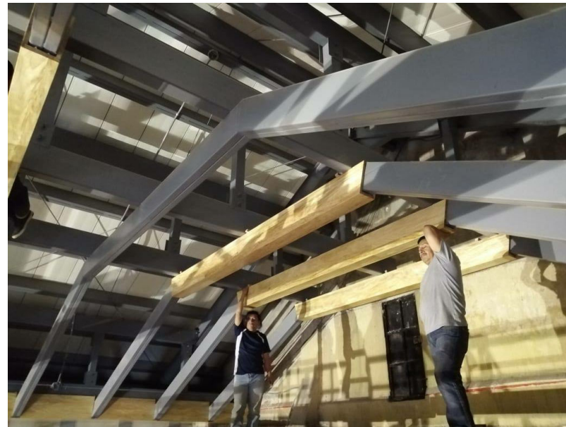
Figura 14 - Forro de madera sobre la nueva estructura metálica de la cubierta. Imagen publicada el 12 de febrero de 2020 en la página de Facebook Parroquia Inmaculada Concepción Villa Nueva , consultada el 24 de agosto de 2020, https://www.facebook.com/PlnmaculadaConcepcionVN/photos/a.1526939647635429/2453387481657303/?type=3&theater .
