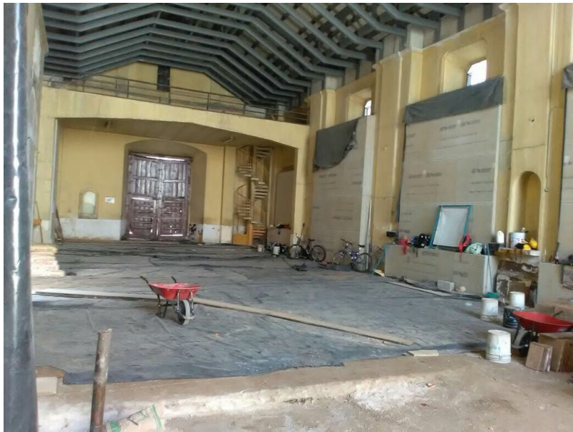
Figura 13 - Reparación y refuerzo del muro lateral norte del templo para soportar la nueva estructura de la cubierta. Imagen publicada el 13 de marzo de 2018 en la página de Facebook Parroquia Inmaculada Concepción Villa Nueva , consultada el 24 de agosto de 2020, https://www.facebook.com/PlnmaculadaConcepcionVN/photos/a.1526939647635429/1939687733027283/?type=3&theater .
