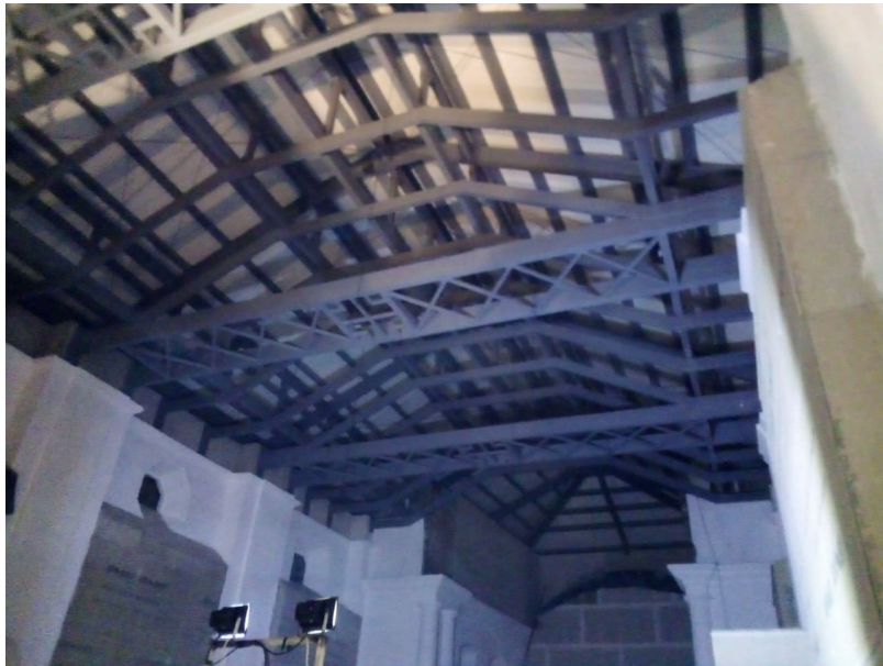
Figura 10 - Cambio de techo, nótese la nueva estructura metálica y la cubierta de doble capa de lámina esmaltada con núcleo rígido de espuma de poliuretano para confort termo-acústico. Fotografía de Armando Moisés Velásquez Fuentes, diciembre de 2016.
