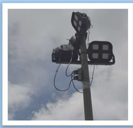
Fotografía 49, Iluminación Parqueo de Tercería
