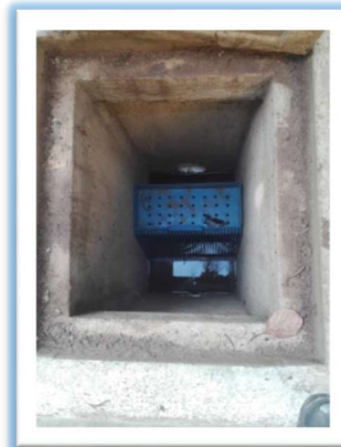
Fotografía 54, Desarenador Planta de Tratamiento
