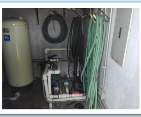
Fotografía 10, Equipo de Bombeo Hidroneumático
