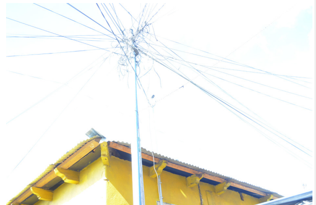
📷 4 Acometida eléctrica para terreno.
