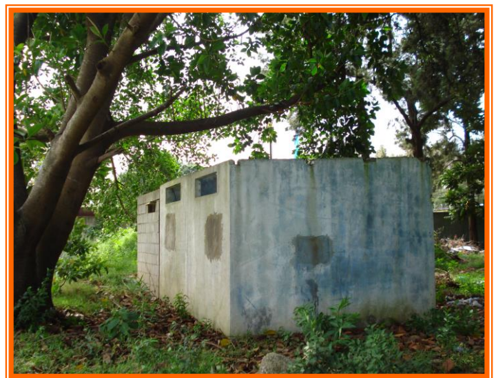
Foto # 17 CONSTRUCCIÓN ABANDONADA Fuente PROPIA
