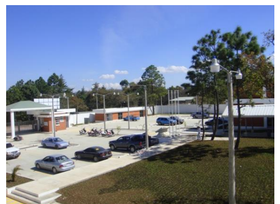
Imagen_025_18032018 Tendido eléctrico, instalación subterránea evitando la exposición del cableado y la contaminación visual
